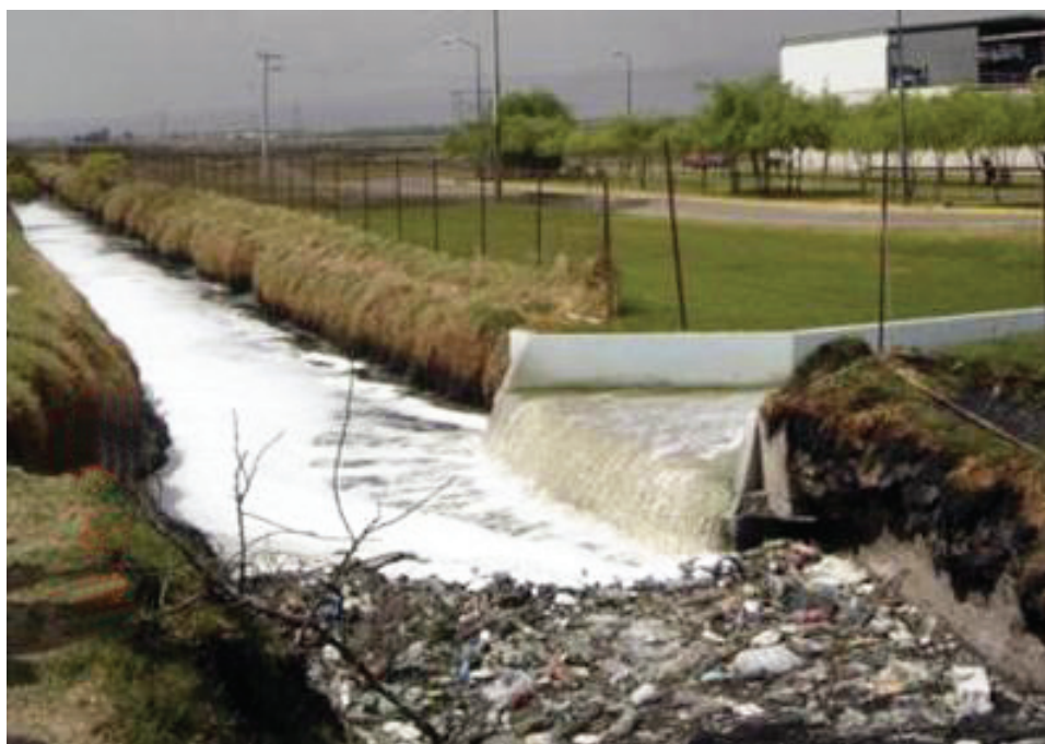
Imagen 1. Descarga de aguas residuales de la Planta de Tratamiento a un tributario del río Lerma, Municipio de Lerma, Estado de México.
